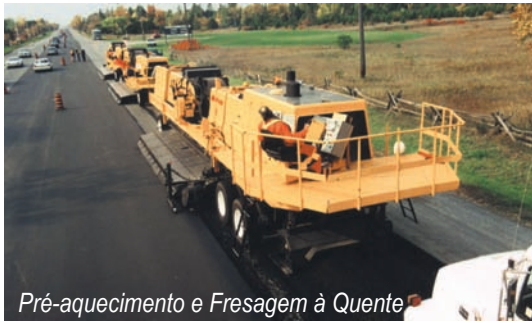
Pleno de Aquecimento
